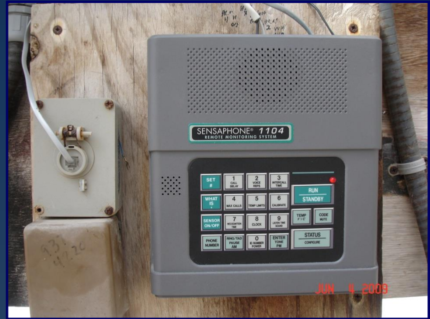
Sistema que aciona telefones
