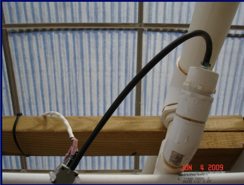
Válvula que aciona o sistema telefônico
